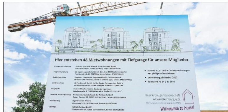
Das Bauschild informiert über das Projekt, den Bauherrn und die beteiligten Planer Foto: Bischof
